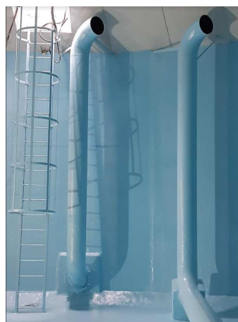
Etanchéité interne cuve n°2 Boisemont 2x4000m3
