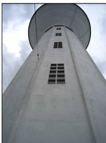
Réservoir de Saint-Ouen- l'Aumône rue d'Epluches 500 m 3
